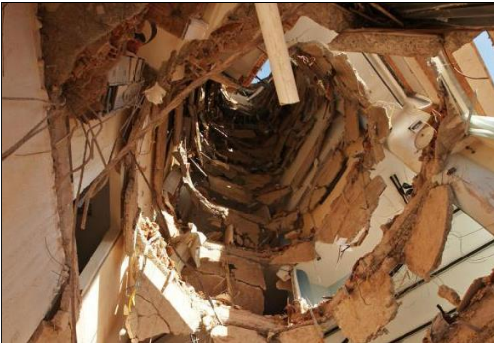
Desabamento parcial de Edifício da Avenida Índico - Centro - São Bernardo do Campo/SP
