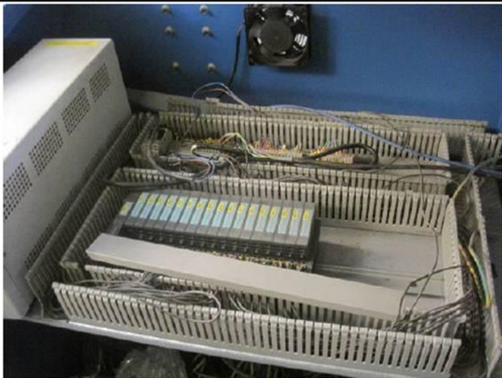
Detalhe das avarias causadas na mesa de comando geral
