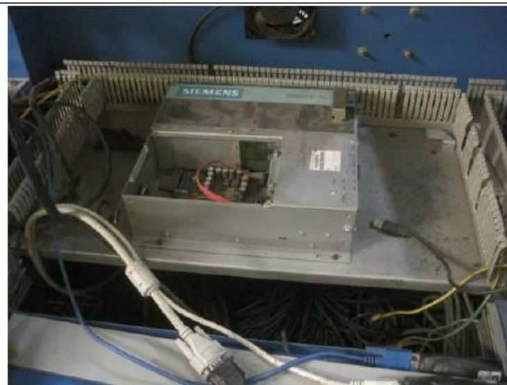
Outro detalhe das avarias causadas na mesa de comando geral
