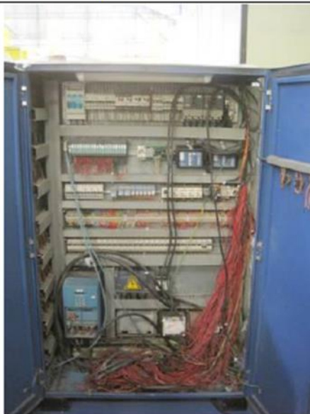
Vista de parte dos painéis elétricos
