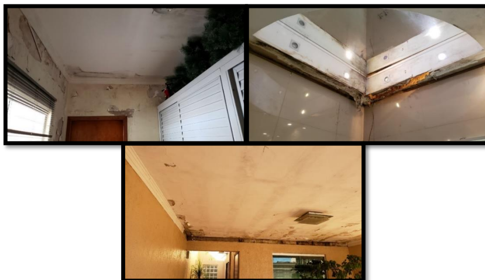
Figura 27 - Situação encontrada. Fonte: Autor.
