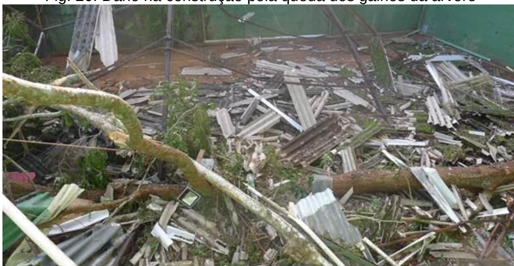
Fig. 21: Dano em parte do telhado da quadra pela queda dos galhos
