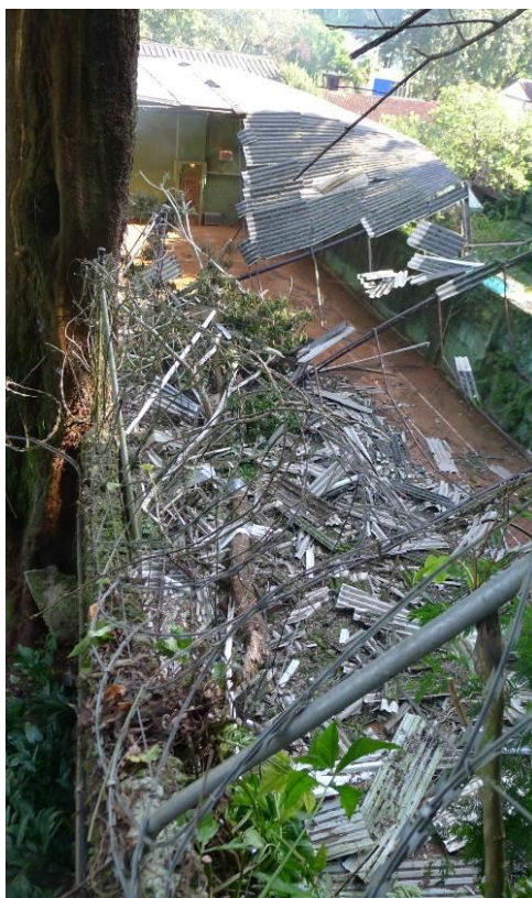
Fig. 20: Dano na construção pela queda dos galhos da árvore
