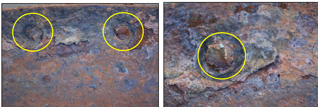
Imagens 05 e 06: em ambas as imagens observa-se a face interna do tampo, exemplificando a fratura completa de parafusos por fadiga (círculos amarelos).
