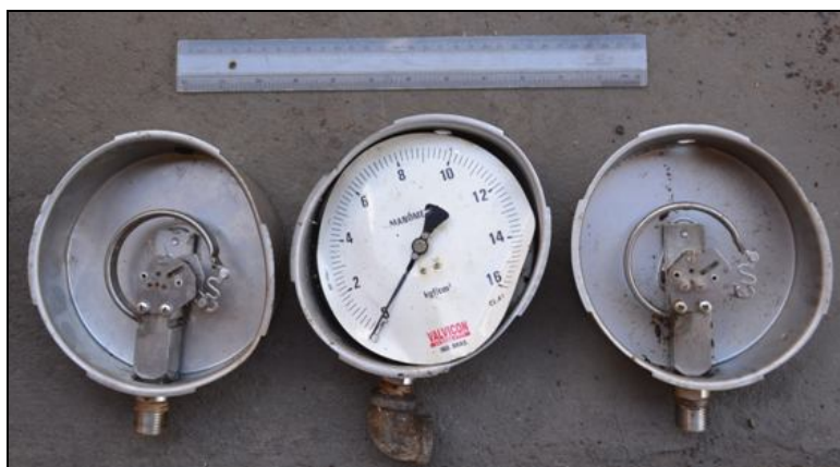
Imagem 07: vista dos manômetros do digestor motivo pericial, bastante danificados pela explosão, com desprendimento e perda de peças e componentes.
