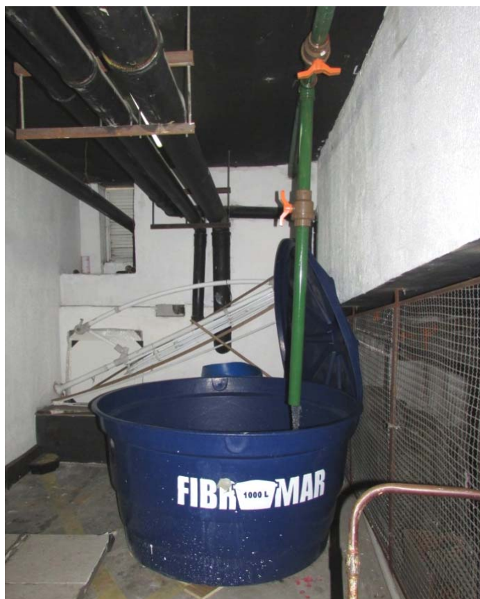
Ilustração 28: Instalação finalizada para os testes.
