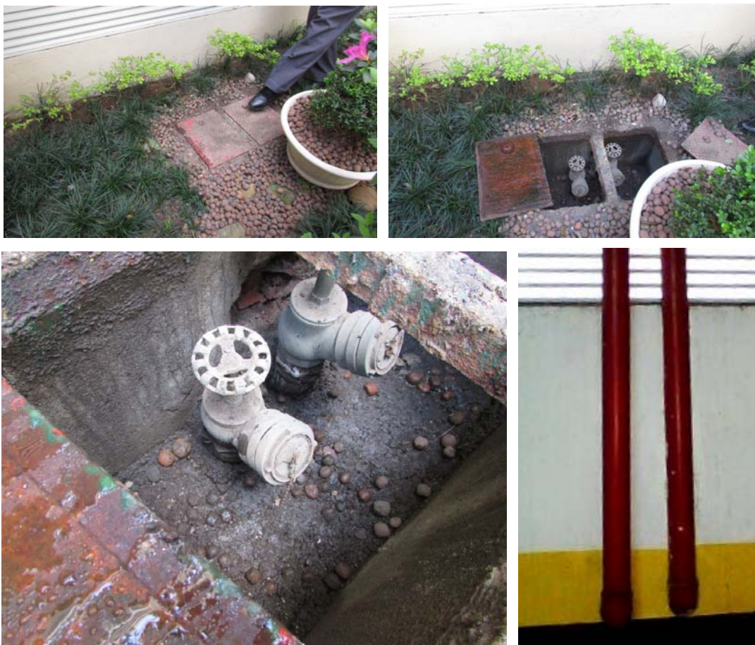
Ilustrações 19, 20, 21 e 22: Caixas de incêndio no piso do pavimento de acesso e tubulações no pavimento de subsolo que alimentam as caixas de incêndio.
