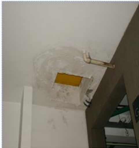
Fato 2: infiltrações pelo alçapão
