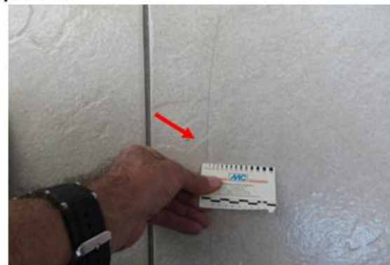
Apto. 201 – fissura em peça cerâmica
