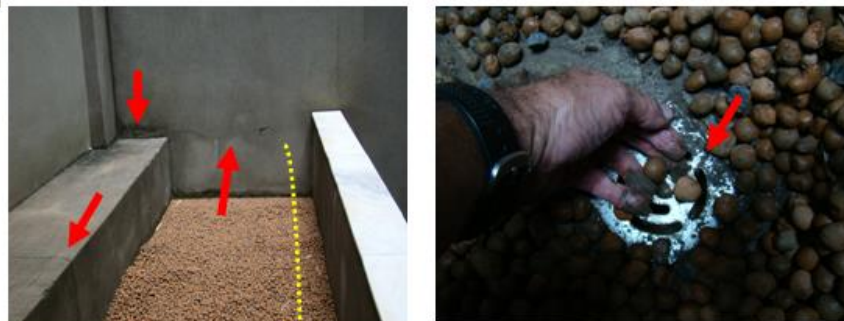
Fissuras em parede, barro e detritos obstruindo o ralo e lodo devido a água acumulada
