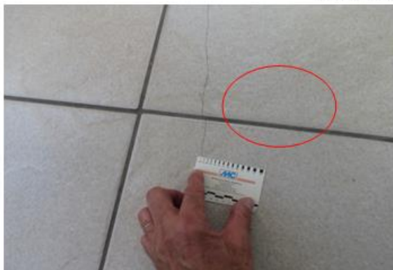
Apto. 201 – fissura em peça cerâmica
