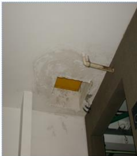
Foto 2: infiltrações pelo alçapão
