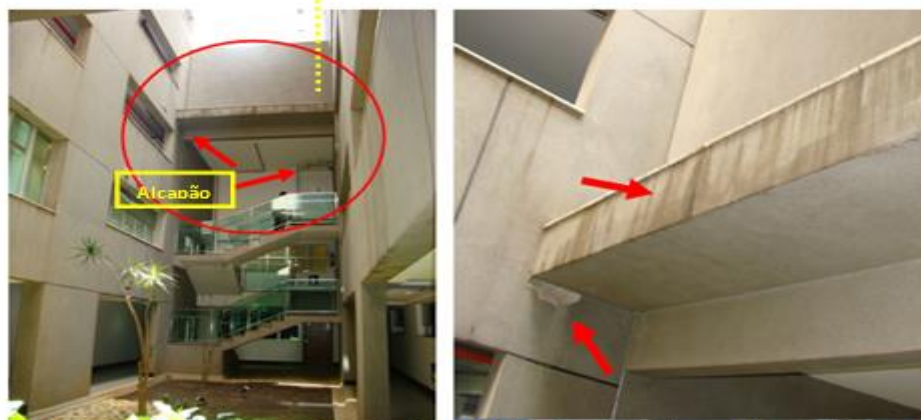
Fato 1: desprendimento de revestimento na junção laje/parede e marcas de escoamento de água pela parede e bordas da laje
