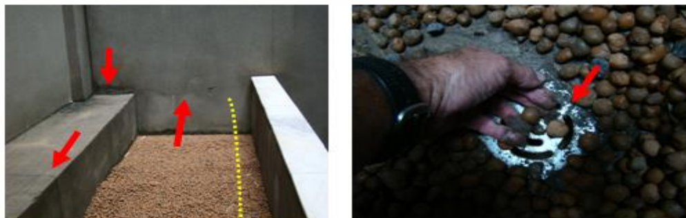
Fissuras em parede, barro e detritos obstruindo o ralo e lodo devido à água acumulada
