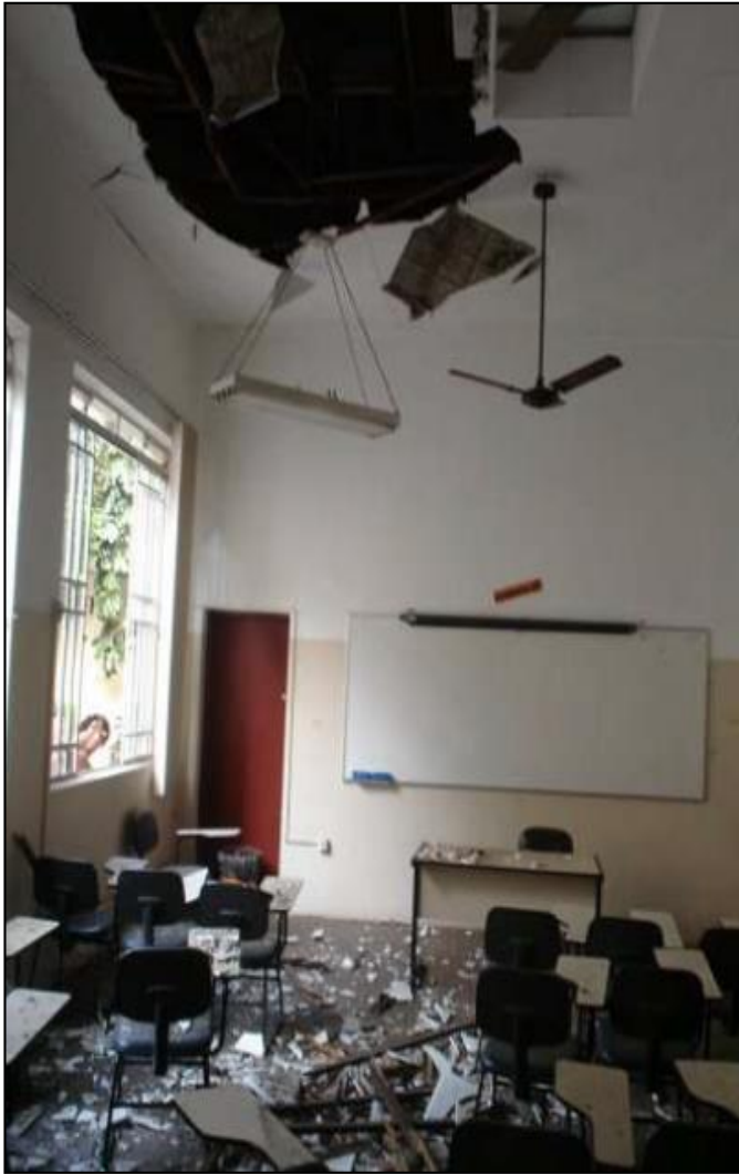
Quede de forro de uma sala de aula
