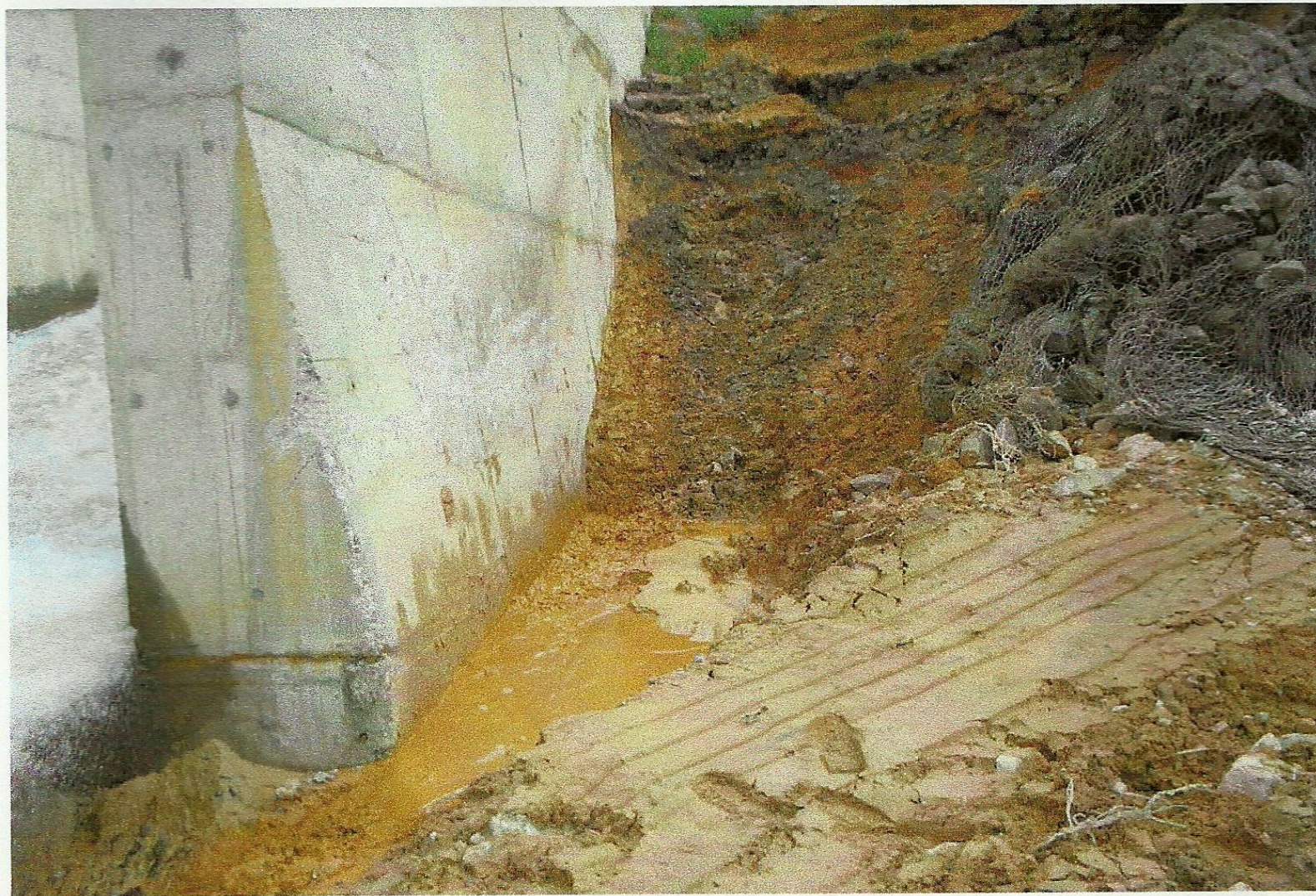
05/01/2008 – Vazamento de água com finos junto ao muro no local onde o gabião foi removido.
