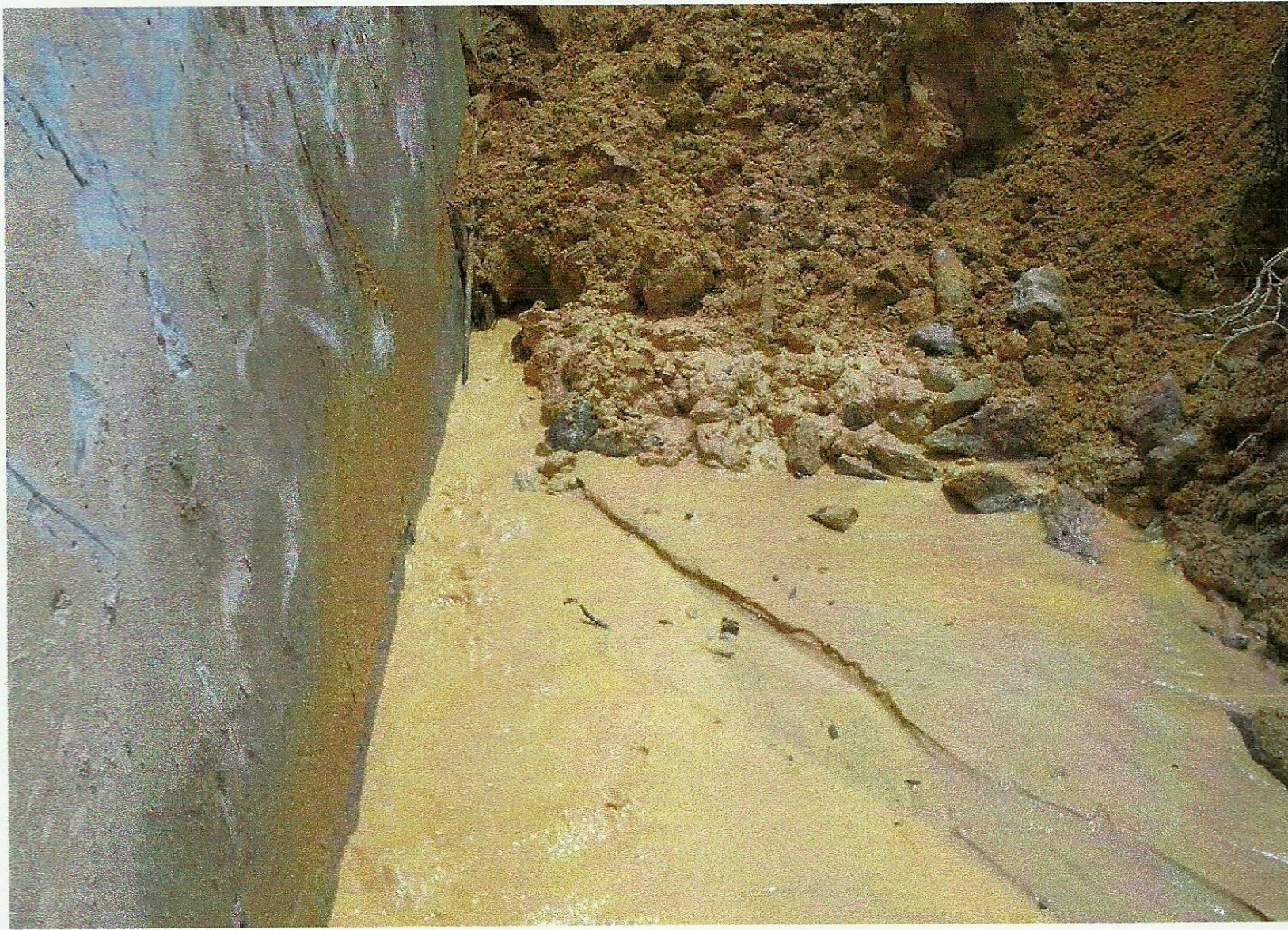
05/01/2008 – Detalhe da surgência de água com finos
