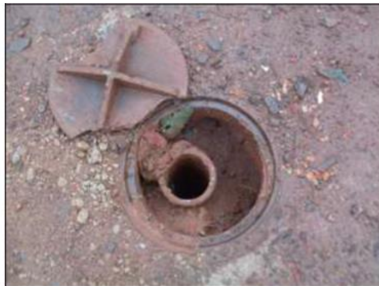
Respiro do tanque enterrado
