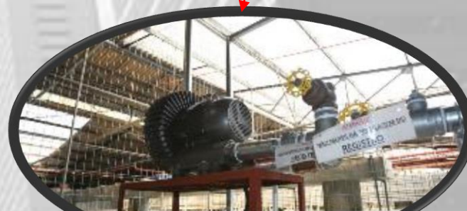
Sistema de drenagem de gás
