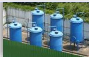
Estação de Tratamento de Gases
