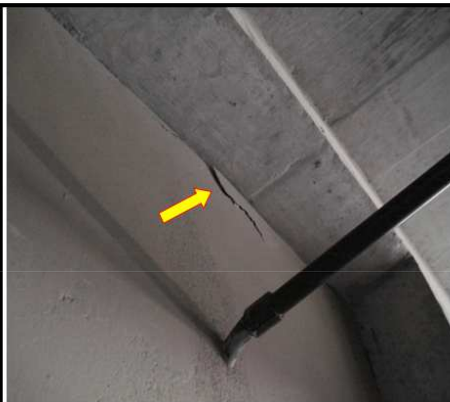
Na realidade, desprendimento do reboco junto de uma viga (Fonte: acervo do Perito)
