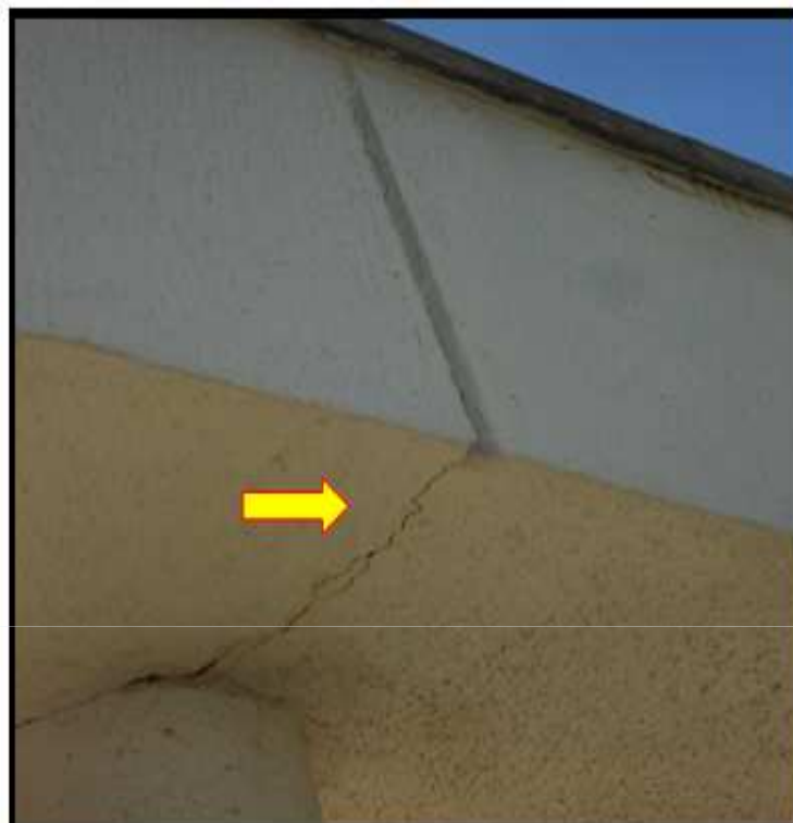
Vistoria judicial: laje repintada sobre junta de dilatação
