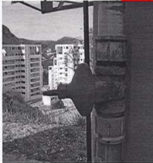
Vista frontal de um registro em acentuado processo de corrosão
